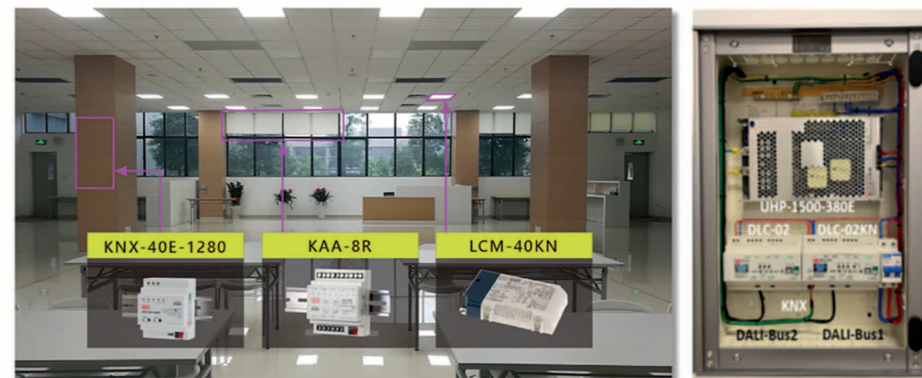
Příklad: Řízení osvětlení KNX & napájení UHP-1500-380E
